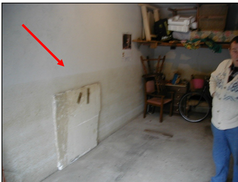
Livello dell'acqua raggiunto nei box
