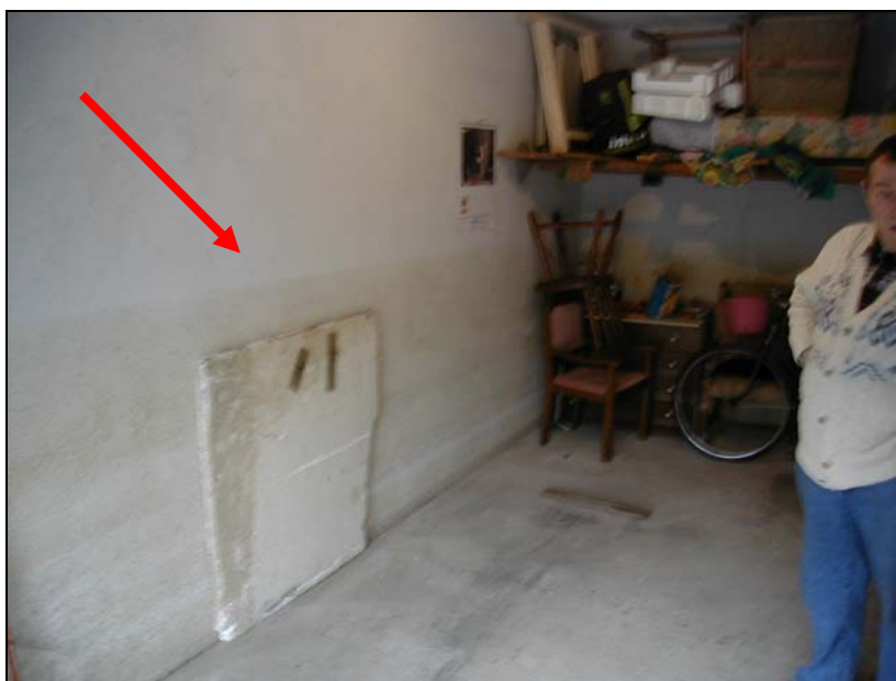
Livello dell'acqua raggiunto nei box
